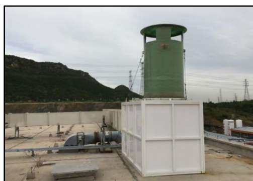
图 19 质检、合成实验室换气处理设施
