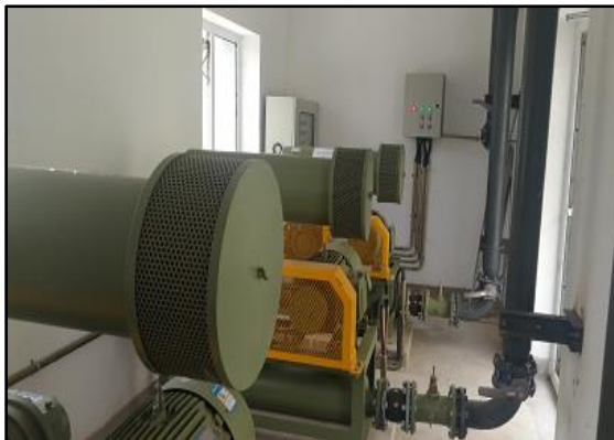
图 10 污水处理设备
