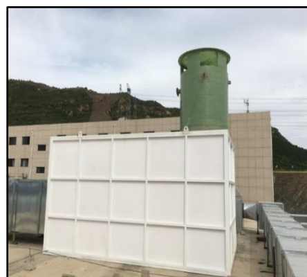
图 15 后提纯工艺尾气处理设施
