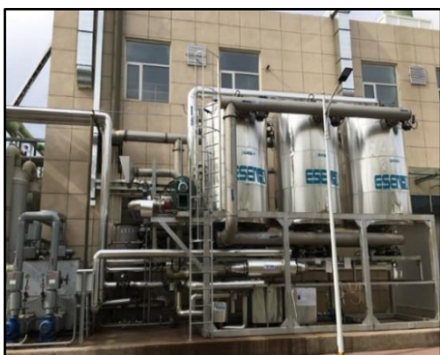
图 14 后提纯工艺尾气处理设备
