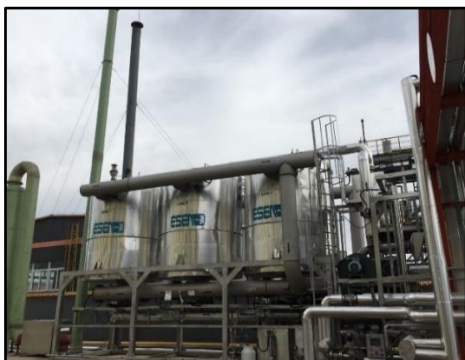
图 18 污水站臭气处理设施
