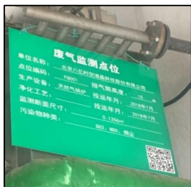
图 21 蒸汽锅炉废气排放口标识牌图
