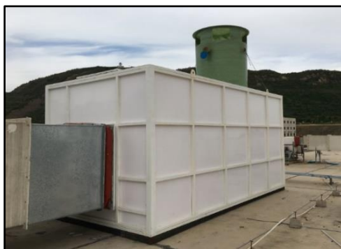
图 20 合成、研发实验室换气处理设施
