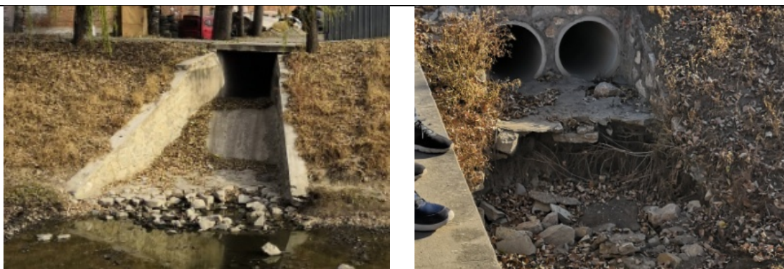
图 15 河槽中多处坍塌
